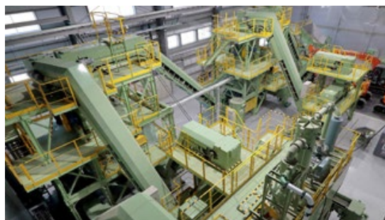
粒度調整・異物除去設備
